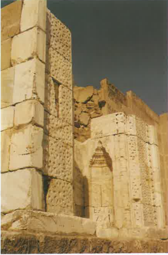
Res.27: Hıdırellez Köşkü portalı (onarım yarım bırakılmış).
