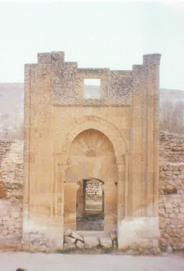
Res. 25: Taşkın Paşa Medresesi portalı onarımdan önce
