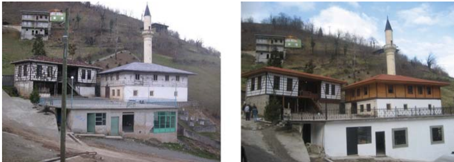
Resim 21: Trabzon-Dernekpazarı Taşçılar köyü camii onarım öncesi ve sonrası
