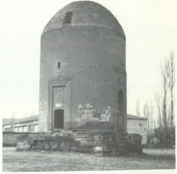
FOTO:8 Kayseri Sırçalı Kümbet (Türbe), doğu ve kuzey cepheden bir görünüş. Kümbetin kalde kısmındaki bozulmalar gün geçtikçe artmaktadır.
