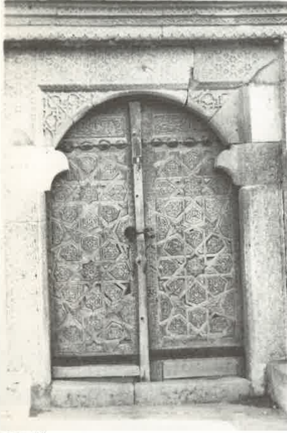
FOTO: 22 Sungurbey Camii ve Türbesi, kuzey cephe giriř kapısının 1984 yılındaki durumu. Burada kapı kanatlarındaki bozulmalar açıkça belli olmaktadır.
