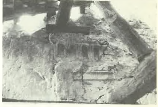
ŞEKL: 4 Doğu cephesinde eklentinin içi ve kapı üstünde devşirme malzeme
